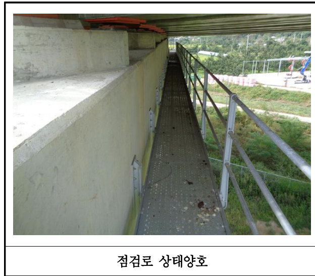
【사진 4.3.26】 교량 점검시설 손상현황
